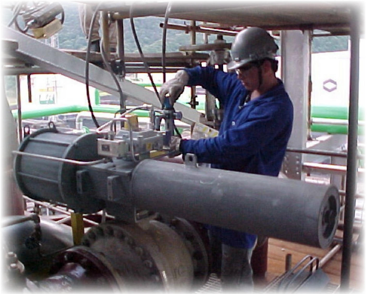
Puesta de servicio en campo Field Commissioning
